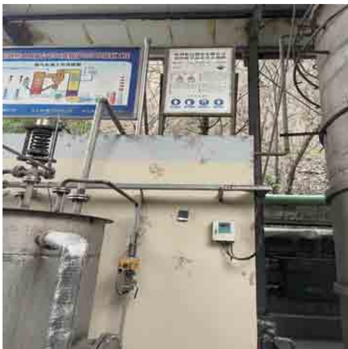
氨泄漏报警装置
