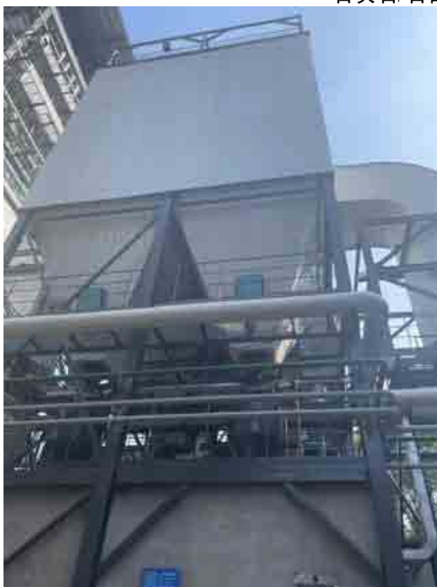
脱硫废水处理设施
