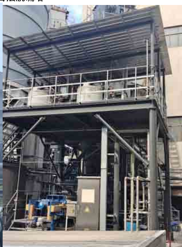
脱硫废水处理设施
